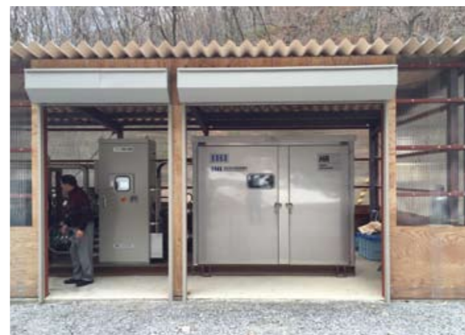
計画が進行中の温泉地に設置された地熱バイナリー発電の設備。
