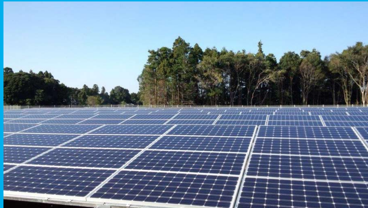
産業用太陽光発電所の設置例：クリーンパワー 阿見町発電所(茨城県)496kW
